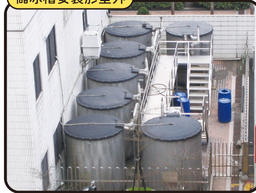
儲冰槽安裝於室外
