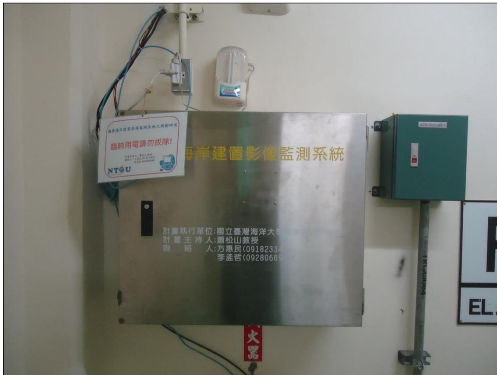
圖 3-17 觀測站主機機箱
