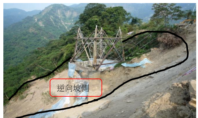
圖 4 既設塔基位於逆向坡側
