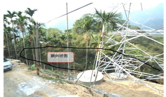
圖 5 新設塔基位於順向坡側
