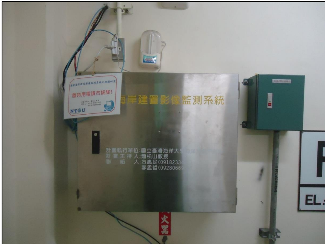
圖 3-17 觀測站主機機箱
