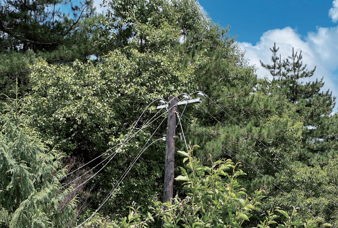
「屏風枝」配電線，醒目的豎立在屏風山新登山路徑上。
