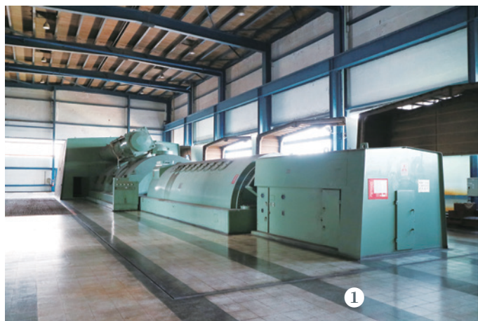
① 協和發電廠的發電機組，未來都將拆除改造。
