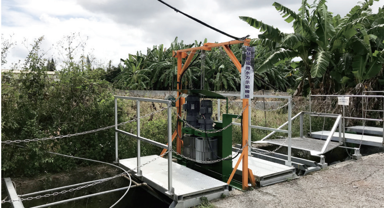
利用吉安圳豐沛水源的福慧有機農場微水力發電系統，為臺灣首個農村微水力電網。
