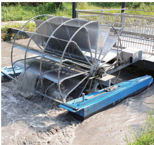
利用浮艇漂浮在安農溪上的台電蘭陽發電廠微水力發電機組。(台電蘭陽發電廠提供)
