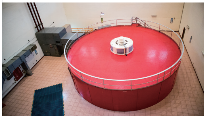
▲ 額定 77,778MVA 的發電機組，為北臺灣單機容量最大的水力發電機。
