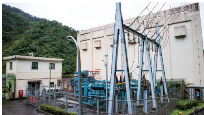
▲ 翡翠發電廠的開關場，發電機發出的電力經由此輸送至台電的輸電網路中。
