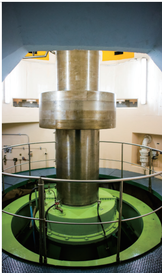
▲ 水車室中連接下方水輪機與上方發電機的軸承。
