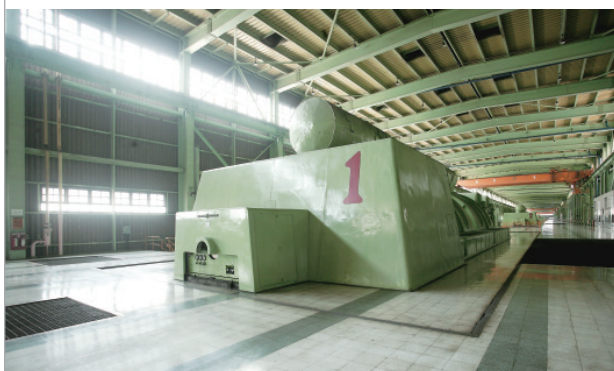
▲ 台中電廠的發電機組。
