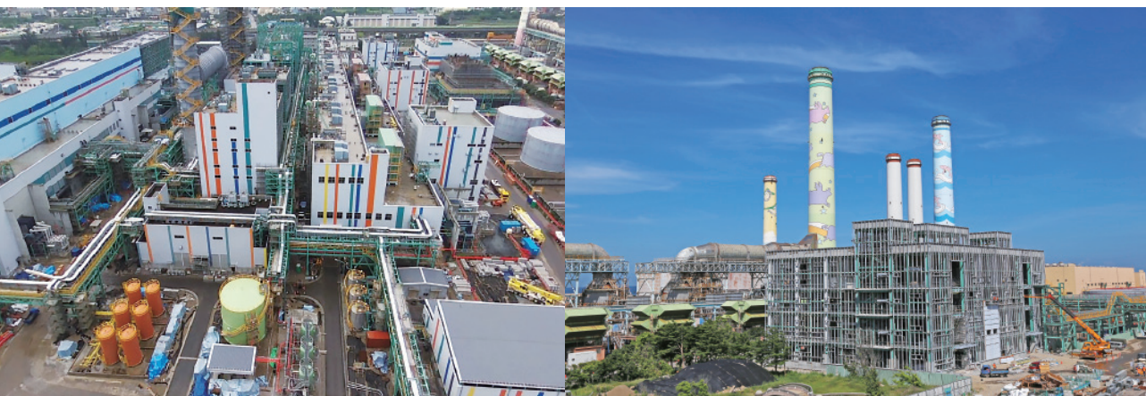
▲ 通霄發電廠現正建置更高效、更環保的複循環機組，一號機組預計於 106 年 10 月商轉，紓緩供電壓力。
