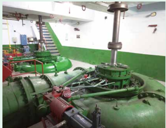
▲ 廠房地下室內的古董，豎軸法蘭西斯式水輪機
