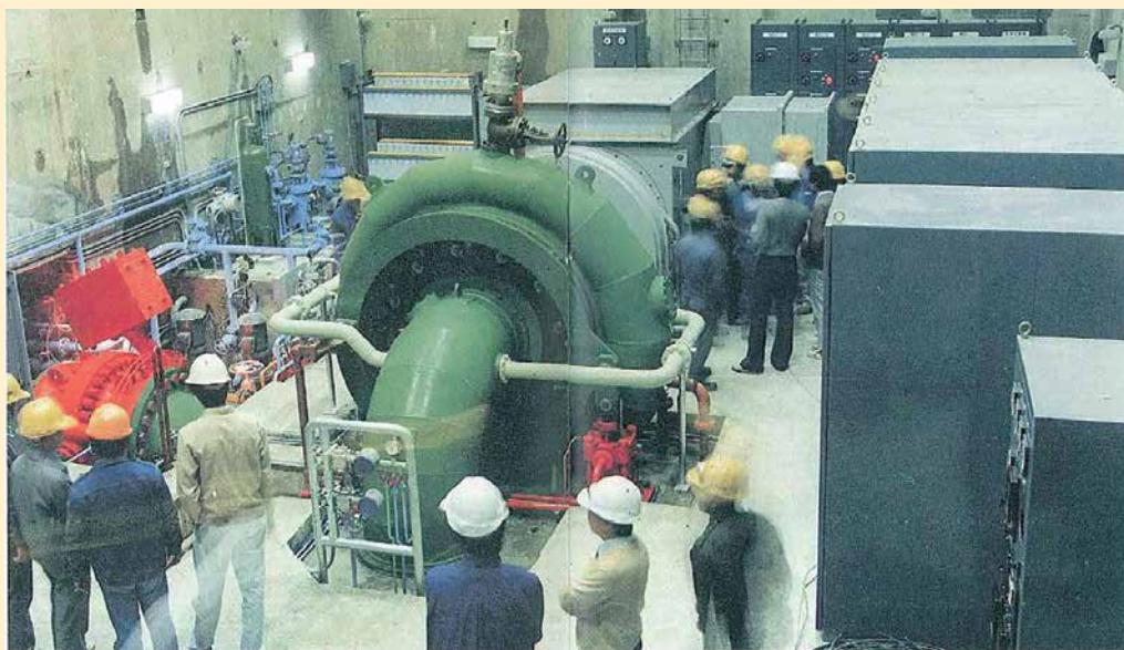
▲ 龍溪發電廠竣工，剛投入運轉時，台電工程人員正緊盯著機組狀況。
