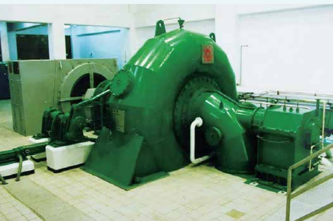
▲ 北山發電廠改建後安裝的全新發電機組
