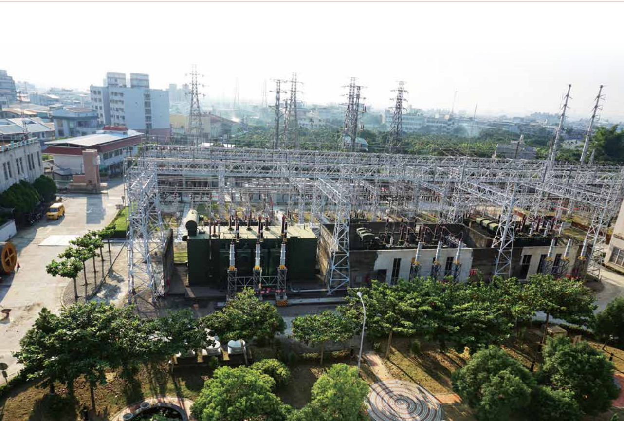
▲ 霧峰變電所攸關中部供電穩定
