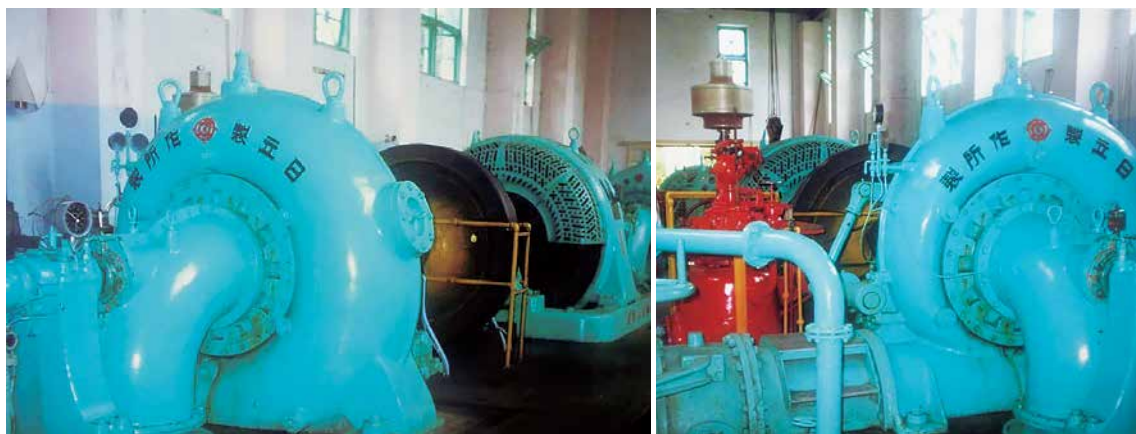
▲ 北山發電廠改建前的發電機組
