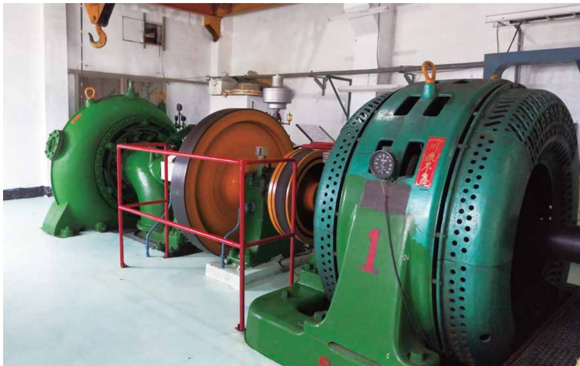
▲ 卑南上圳發電廠 1 號發電機組全貌
