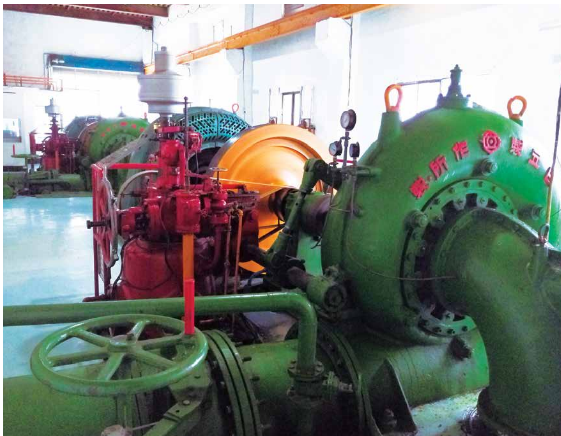
▲ 卑南上圳發電廠機組側寫
