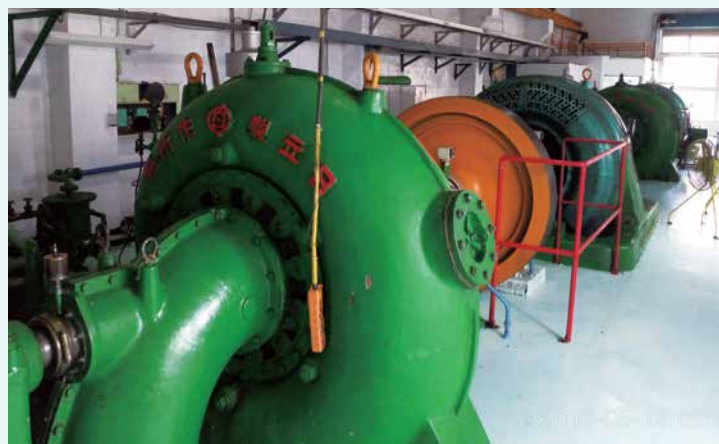
▲ 卑南上圳發電廠水輪機渦殼
