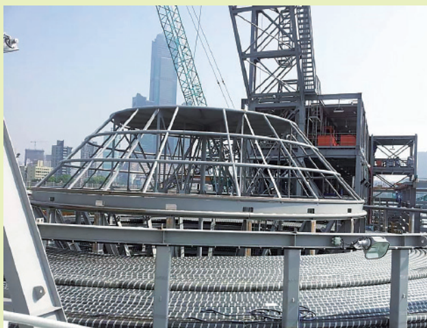
▲ 臺澎海底纜線在岸邊的儲纜設備。
